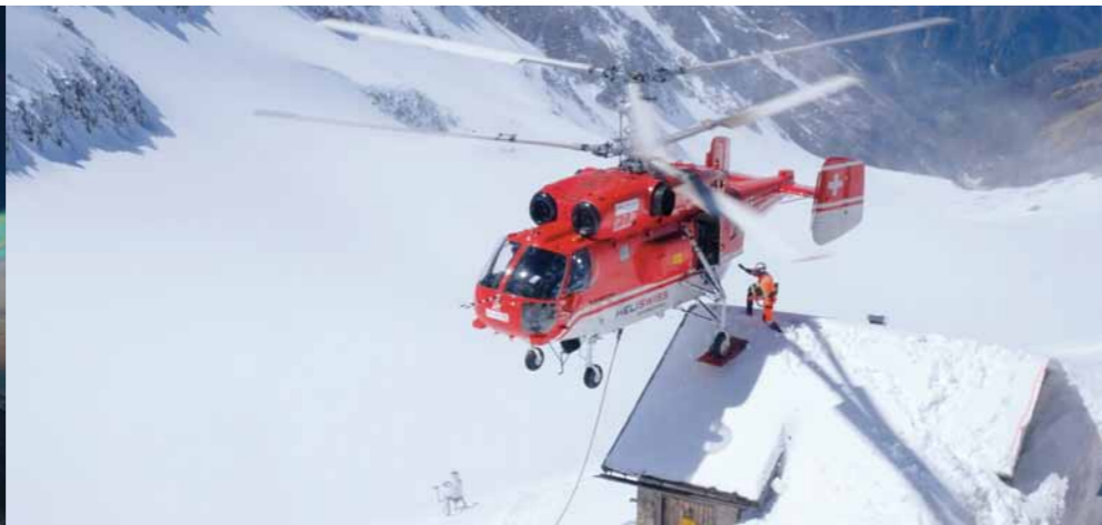
Austausch eines Stromaggregats Replacement of a power generator
